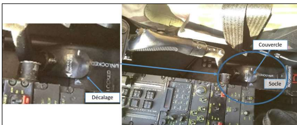
Figure 4 : position du manche avec un mauvais montage
