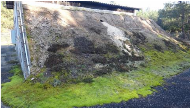
Photo 2 : exemple de phénomène de tassement
