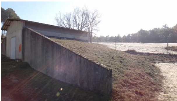
Photo 3 : exemple de phénomène de tassement
