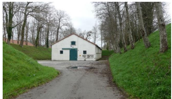
Photo 4 : présence d'arbres sur les merlons
